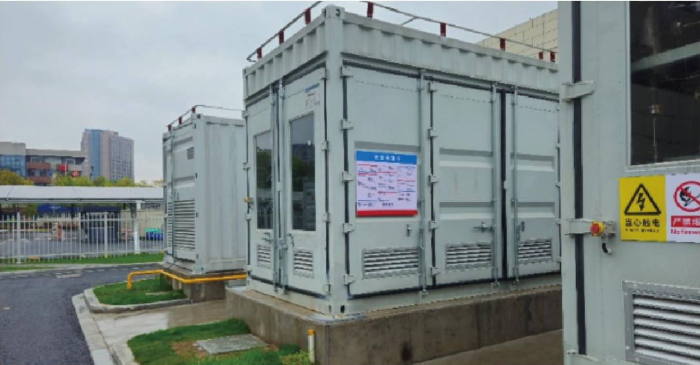
📍 国家电网钠离子储能系统
